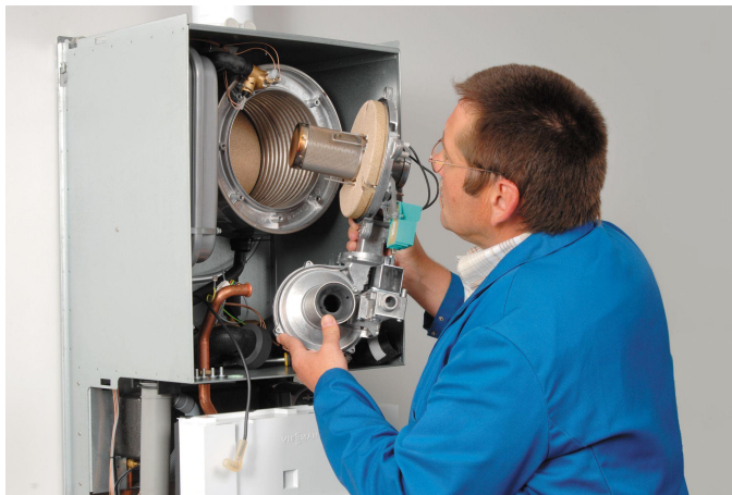
Bild 4: Wichtige Voraussetzungen für einen möglichst sparsamen Heizbetrieb sind der hydraulische Abgleich zur Optimierung der Anlage sowie regelmäßige Wartung.
